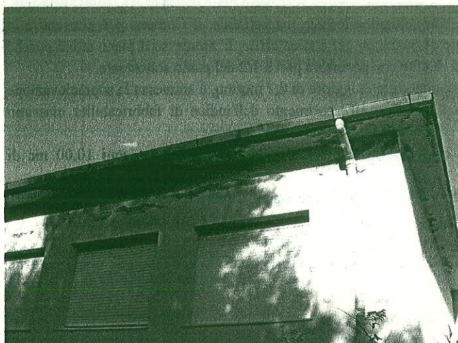
Foto 4. Fenomeni di degrado e erosione cornicione
