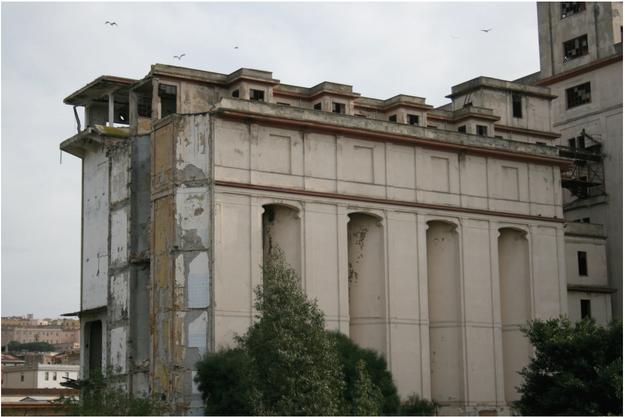
Immagine dello stato di conservazione del manufatto. [4]
