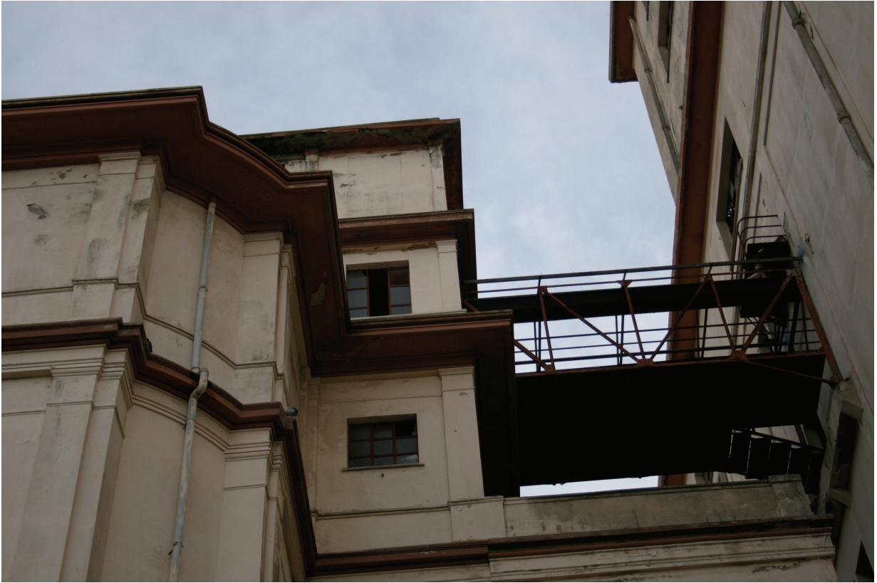
Immagine dello stato di conservazione del manufatto. [10]
