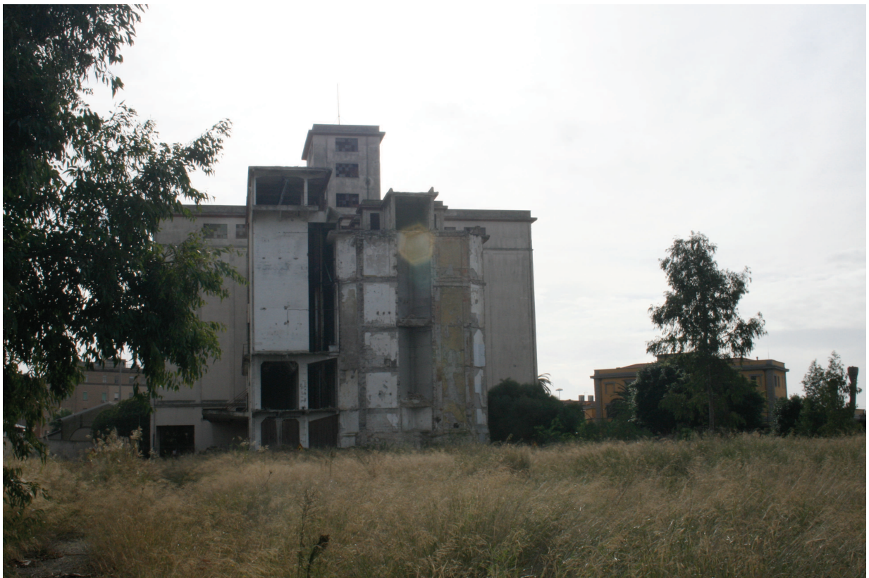
Immagine dello stato di conservazione del manufatto. [1]
