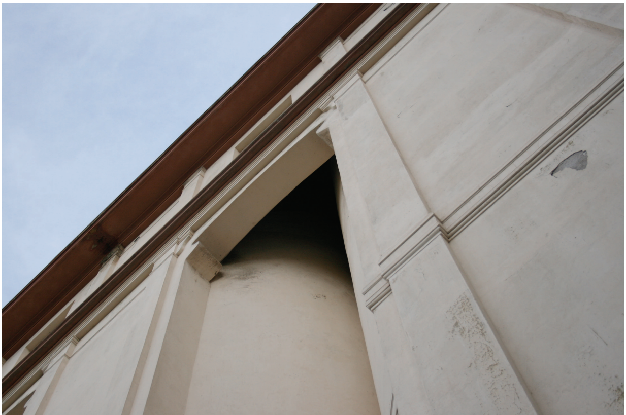
Immagine dello stato di conservazione del manufatto. [9]
