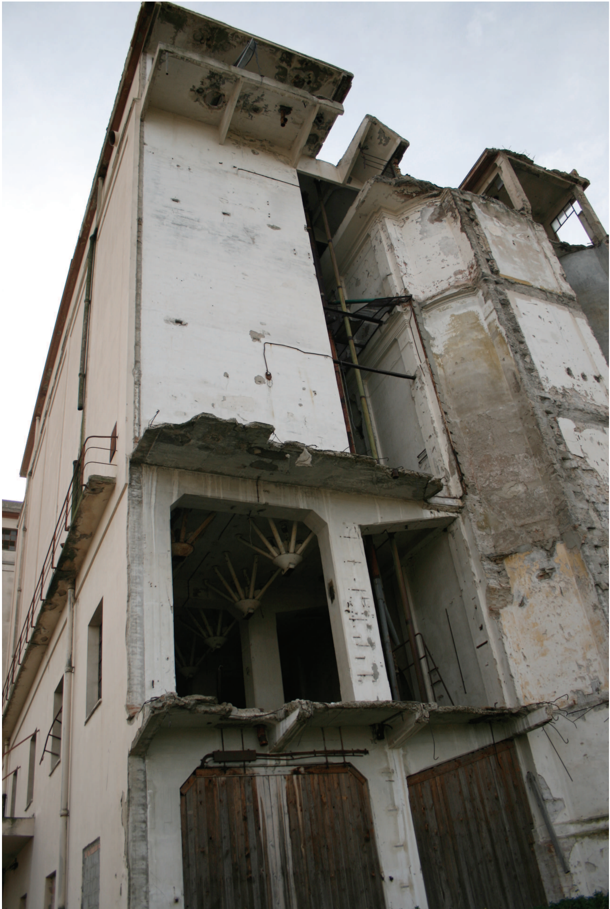
Immagine dello stato di conservazione del manufatto. [5]
