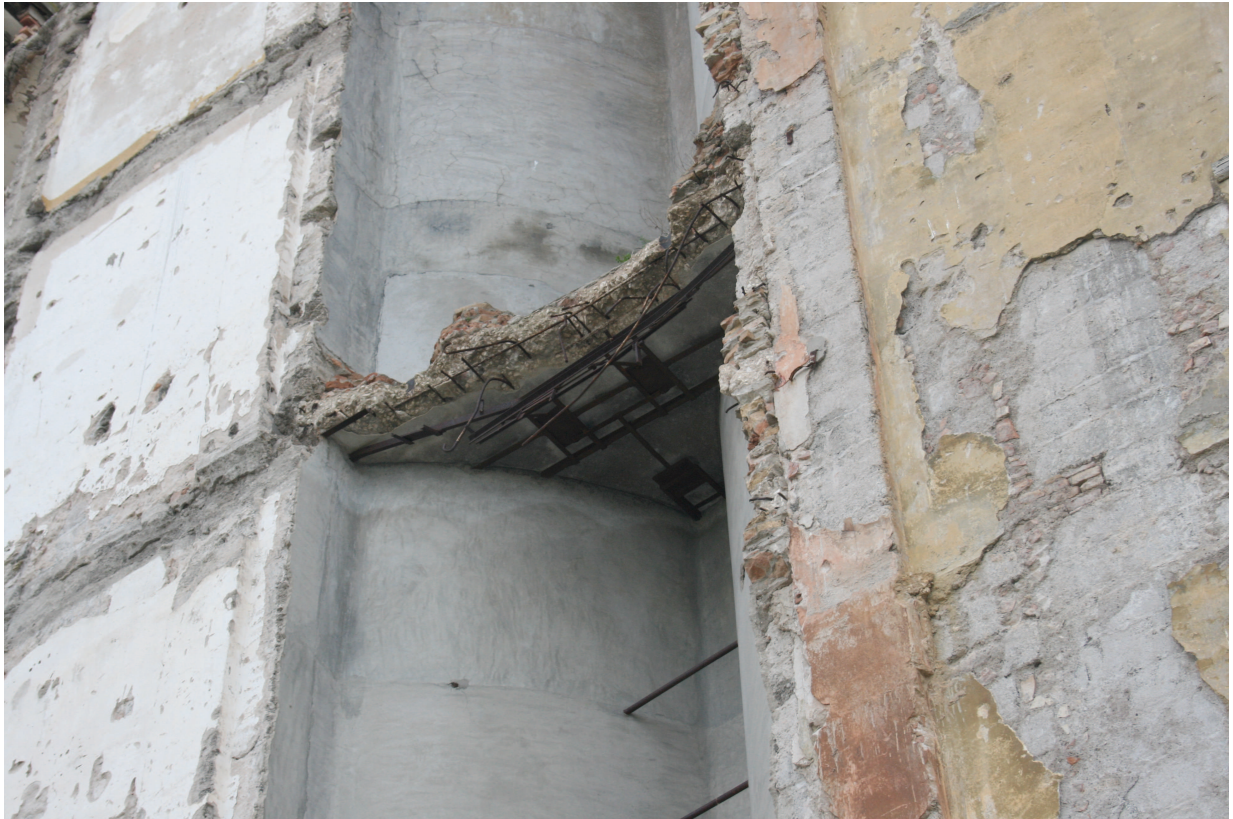
Immagine dello stato di conservazione del manufatto. [8]
